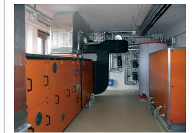
Abbildung 1 Pilotanlage zur Solaren Klimatisierung mit Flüssigsorption Quelle: Fa. Menerga Apparatebau
